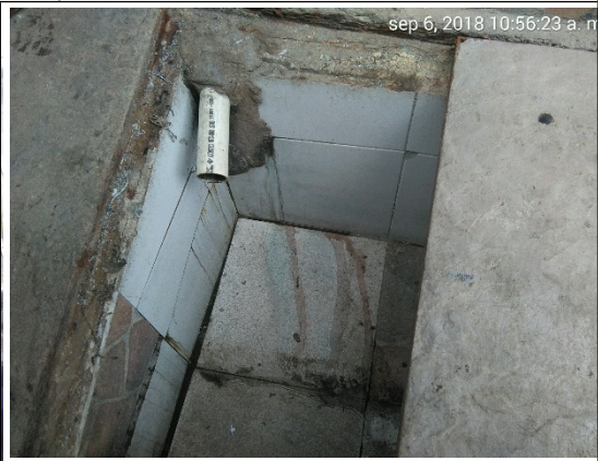
Foto No. 6 Caja de inspección externa.
