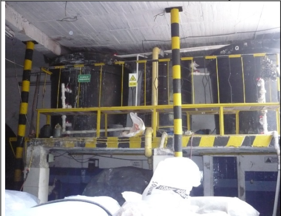
Foto No. 5 Sistema de tratamiento de ARnD.
